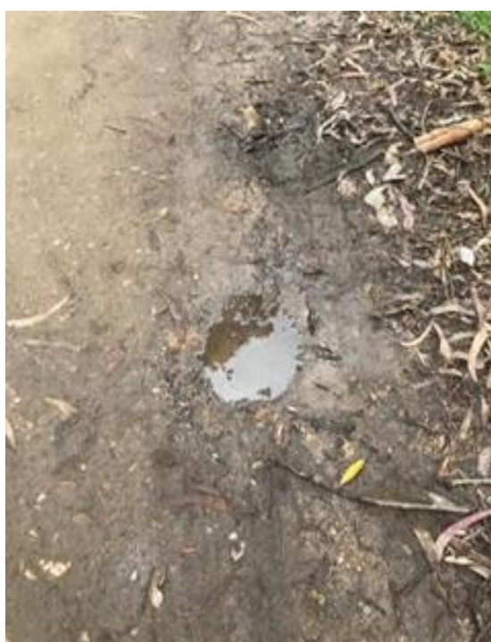
Zona de empozamiento (proyección alcantarilla)
