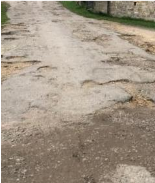
Estado pavimento flexible
