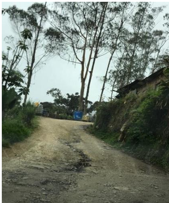
Afrimado en mal estado
