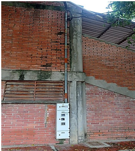
Figura 7. Acometida aérea y tablero general de CENS
